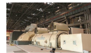
China Power Investment Ланьчжоу новый район когенерации проекта
